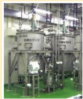
薬液供給装置
